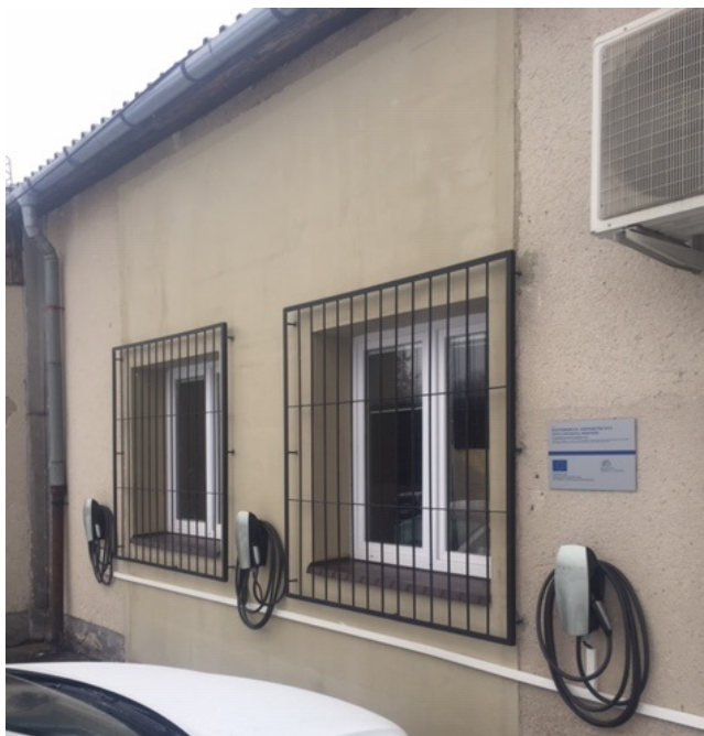
Společnost Babynabytek s.r.o. do svého majetku pořídila elektromobily a nabíjecí stanice značky Tesla.
